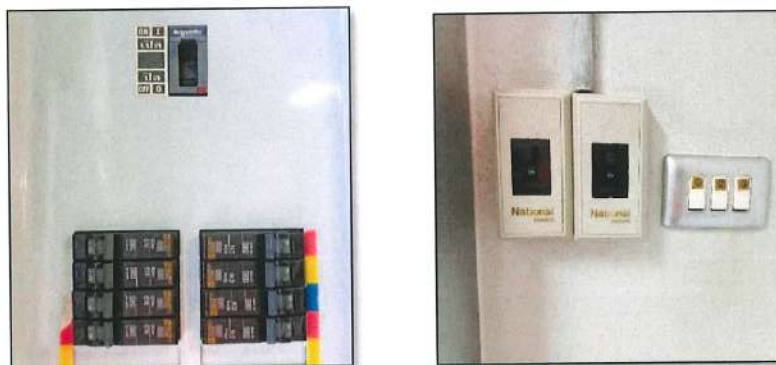
ภาพที่ 26 ระบบไฟฟ้า
